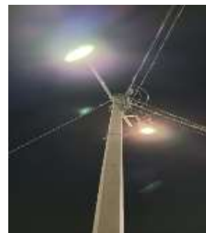
POSTE DE ALUMBRADO PUBLICO SOBRE CARGADO
